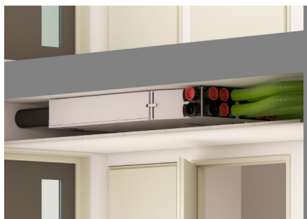
Renovent Sky 150 et caisson de distribution d'air installés en faux-plafond dans un couloir.
