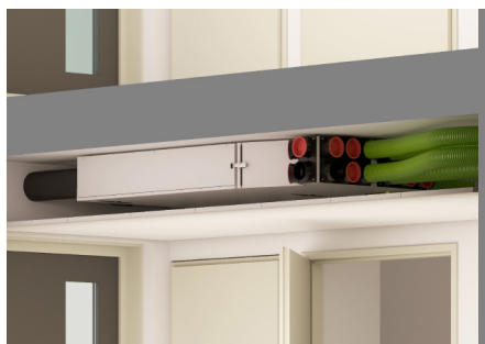
Renovent Sky 150 et caisson de distribution d'air installés en faux-plafond dans un couloir.
