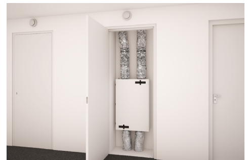
Installation Renovent Sky 200 dans un placard technique coupe-feu accessible depuis le couloir (accès facilité pour la maintenance)
