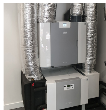
Installation dans un local technique Flair 325 et Air Comfort
